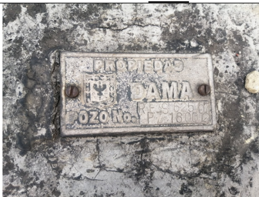
Foto No. 3. Placa de identificación de sellamiento definitivo.
